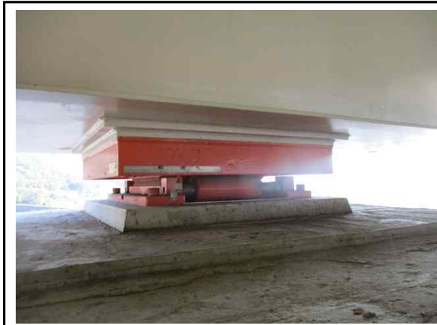
교량 받침 이동량 상태
