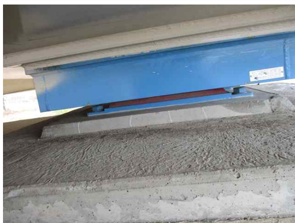
P12-Sh2 무수축몰탈 균열(0.3mm미만)
