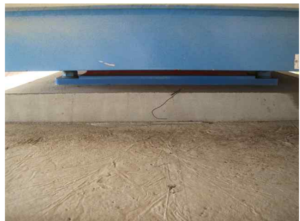
P10-Sh1 무수축몰탈 균열(0.3mm미만)
