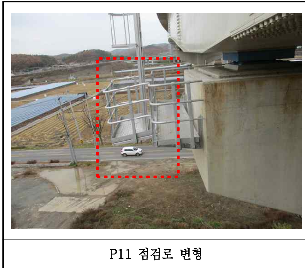
【사진 41.3.24】 교량 점검시설 손상현황
