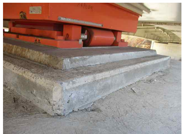
P13-Sh2 받침콘크리트 재료분리
